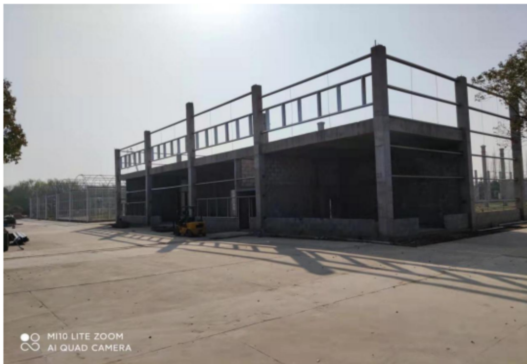
配电站外接线及变压器安装未完成
